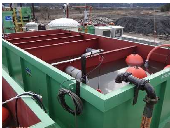
油水分離槽 10m 3
