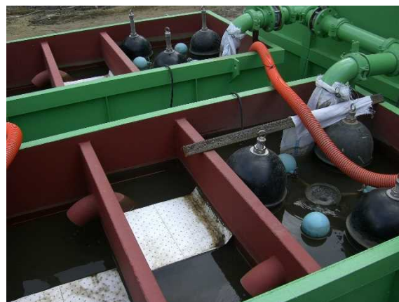
油水分離槽 10m 3
