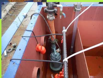
放流部は水中ポンプ方式 もしくは4インチホースタケノコによる 自然放流方式
