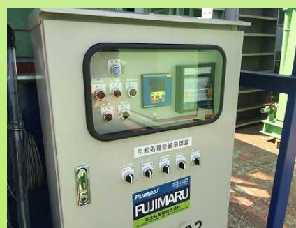
操作簡易な処理装置制御盤 PH指示計×1、放流PH記録計×1
