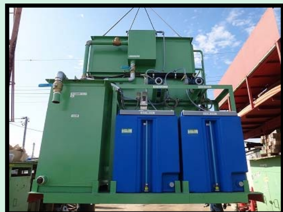
凝集剤槽(PAC・高分子凝集剤)
