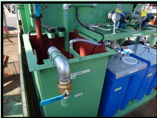
反応槽(凝集剤添加部)
