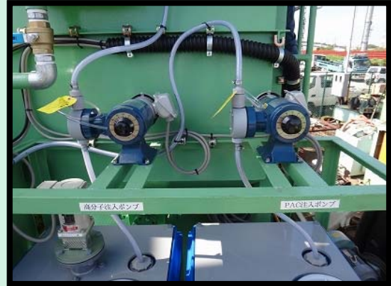
凝集剤添加ポンプ ° (PACおよび高分子凝集剤)
