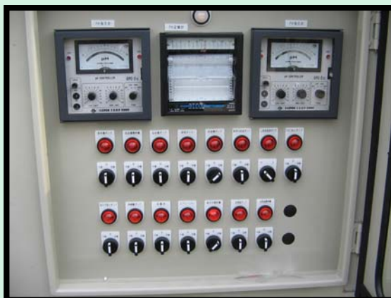
処理装置制御盤
